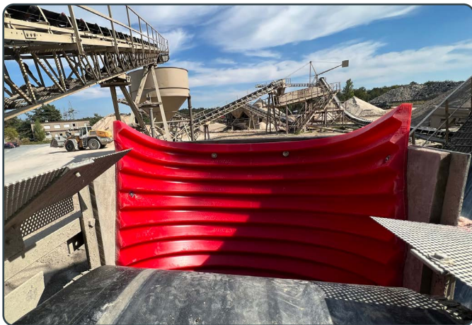
SZ-Platten verschraubt im Prallbereich eines Förderbandes
